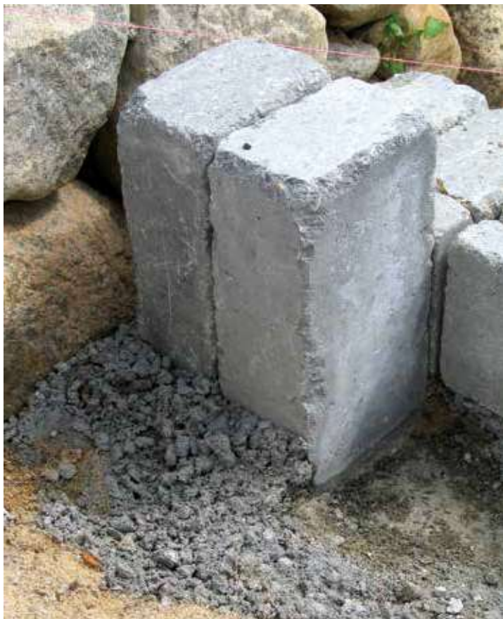
Betonblokkene skal bankes godt ned i den jordfugtige beton. Bagefter laves trekantstøbningen bagved.
